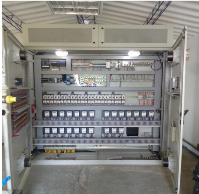
Figura 8. Centro de Control de Motores (CCM).
