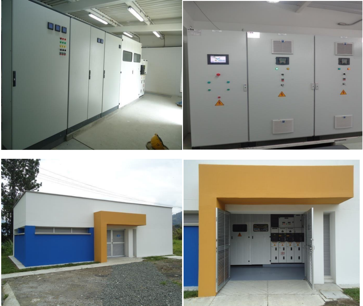
Figura 6. Subestaciones eléctricas de la planta de tratamiento de Aguas
